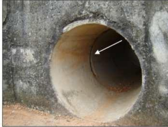
Figura A-1. Pérdida de mortero de pega en la unión de la tubería
