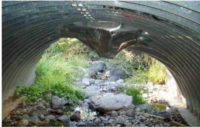
Figura A-9. Colapso de tubería metálica corrugada
