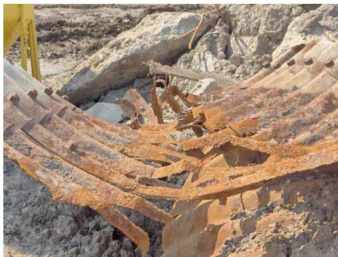
Figura A-8. Pérdida de sección de alcantarilla metálica corrugada debido a corrosión
