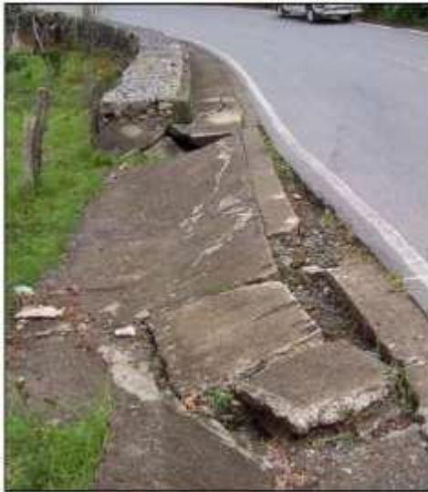
Figura A-14. Fracturamiento del revestimiento
