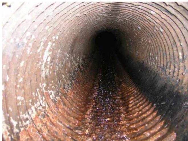
Figura A-7. Corrosión en una alcantarilla metálica corrugada
