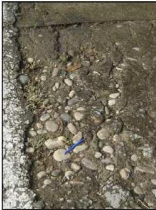
Figura A-10. Desgaste de la superficie del revestimiento con alta rugosidad
