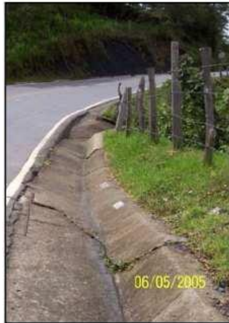
Figura A-11. Agrietamiento en el revestimiento con presencia de vegetación
