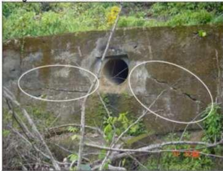
Figura A-2. Grietas en muro de cabezal
