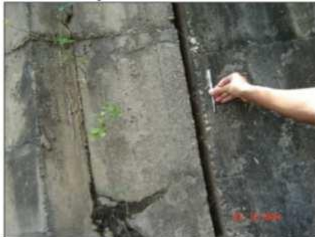
Figura A-4. Grieta vertical en la unión entre el muro cabezal y los aletones
