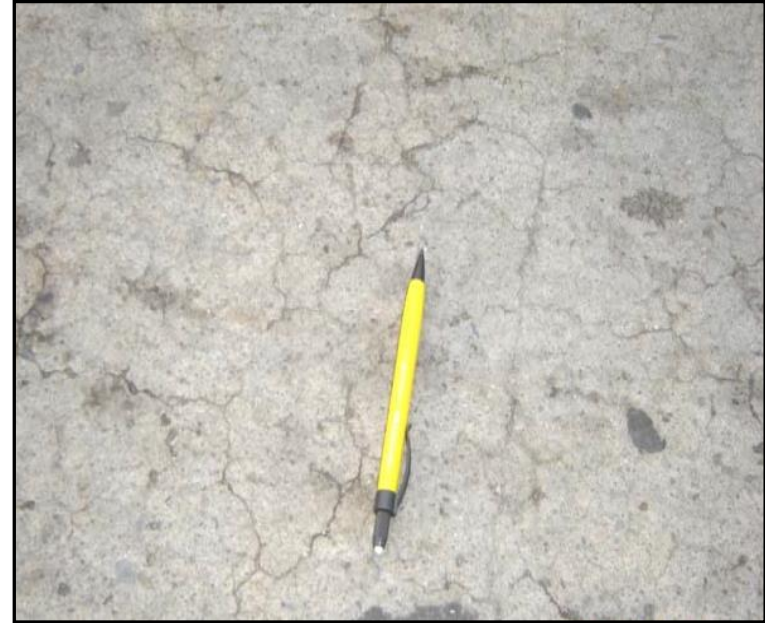
Figura 2.45 Imagen asociada a la Grieta por Contracción
