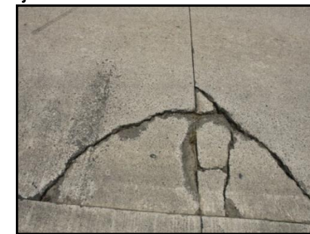
Figura 2.44 Imágenes de los niveles de severidad asociados a la Grieta de Esquina
