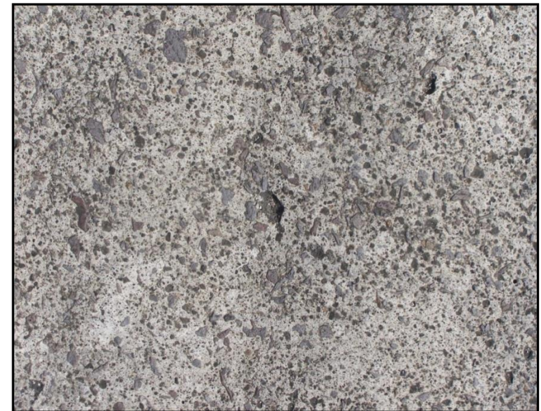
Figura 2.56 Imagen asociada a Desprendimiento de Agregados
