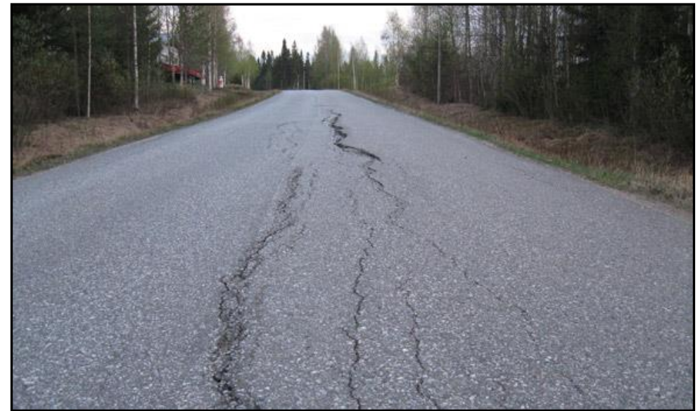
Figura 2.25 Imagen del nivel de severidad alto asociados a Hinchamiento
