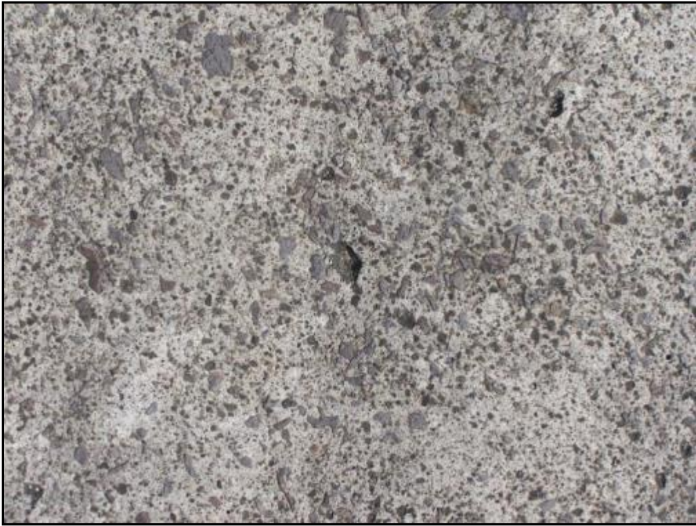
Figura 4.57 Imagen asociada a Desprendimiento de Agregados
