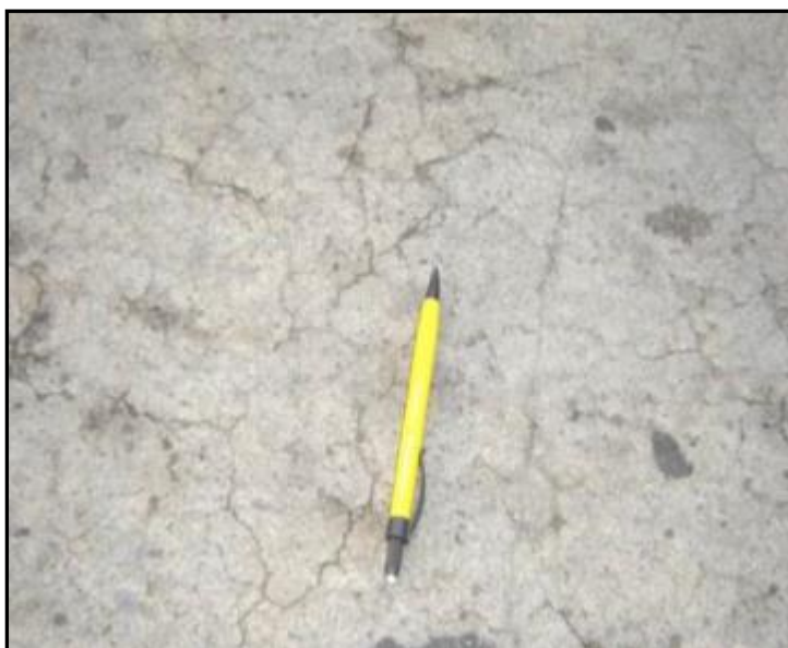
Figura 4.46 Imagen asociada a la Grieta por Contracción
