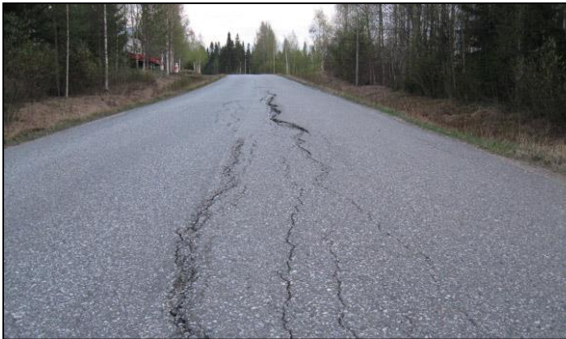
Figura 4.25 Imagen del nivel de severidad alto asociados a Hinchamiento
